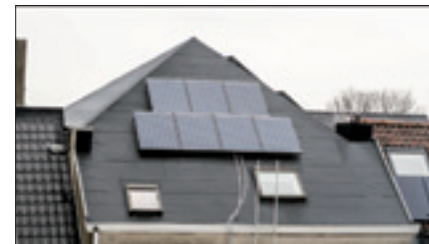
図 8-17 ソーラーパネル (後付けの屋根)
