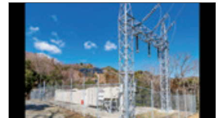
図 8-18 手前の変電施設と奥に見えるソーラーパネル群
